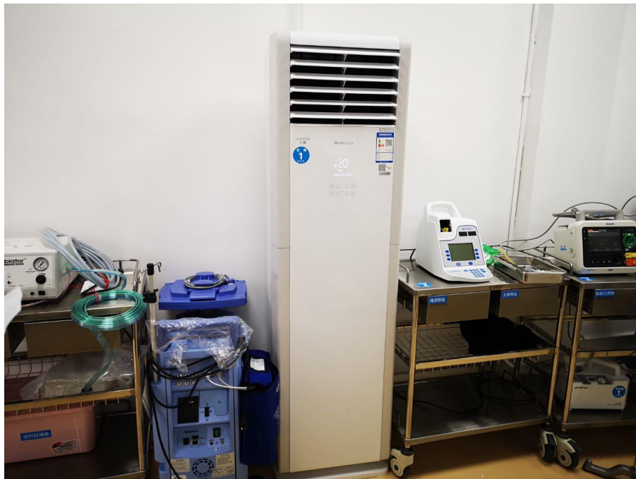
图 4-7 本项目通风装置
